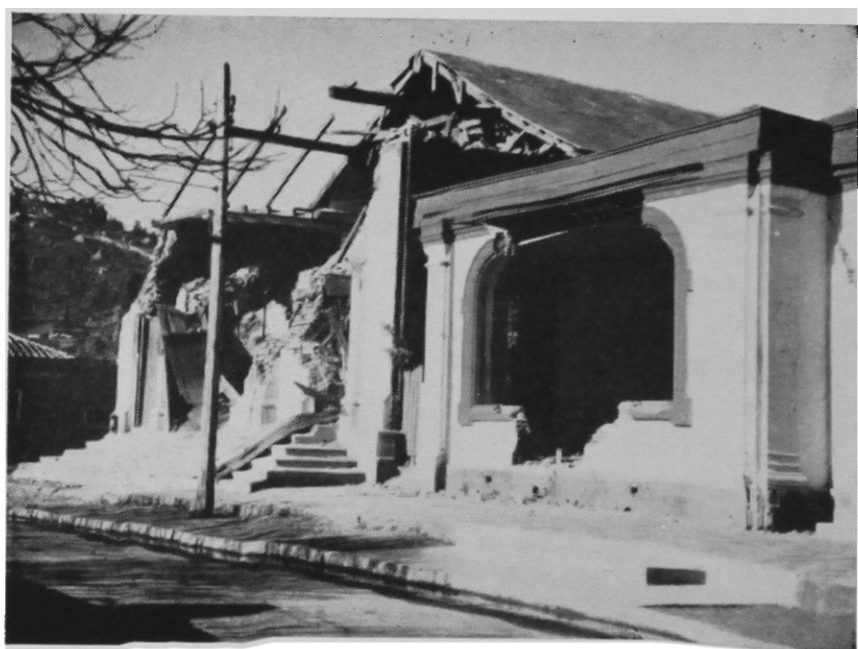
Lebu: Daños en Iglesia de Lebu
