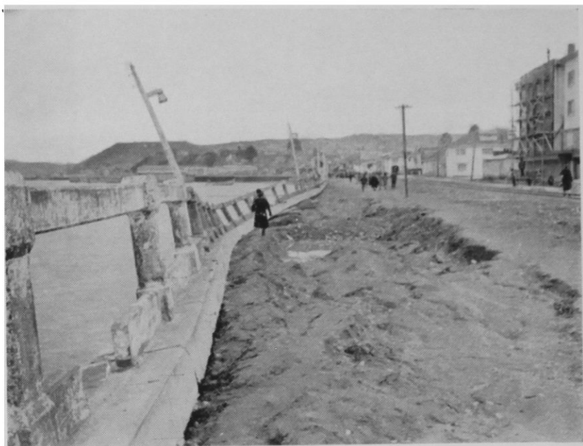
Puerto Montt: Daños en terreno de relleno artificial junto a la Costanera
